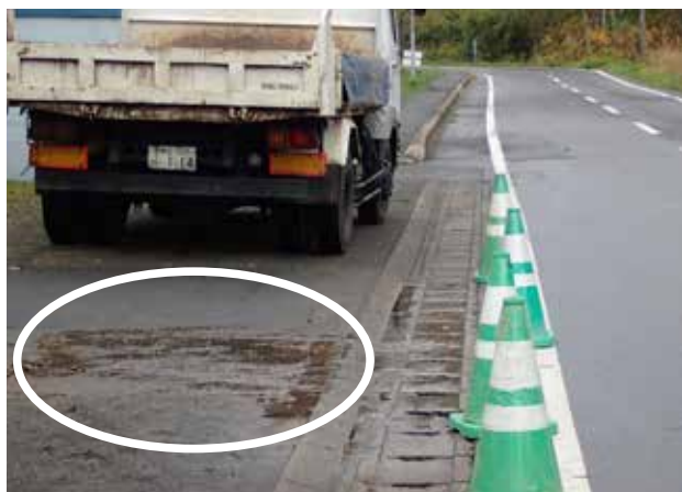
▲地面から水が流れる漏水現場(丸印の部分)
