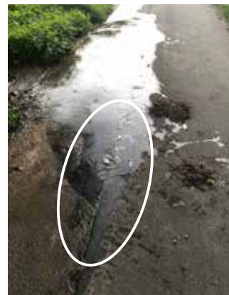
▲舗装の割れ目から水が吹くことがあります
